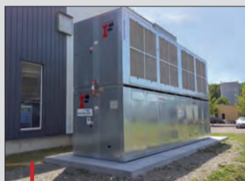
Martiplast a installé trois refroidisseurs hybrides type Sireg sur le nouveau site d'EMI.
