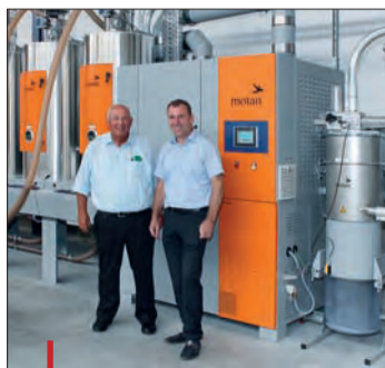
Herbert Bergmann (à gauche) et un responsable technique de Motan devant la nouvelle station de séchage centralisée.
